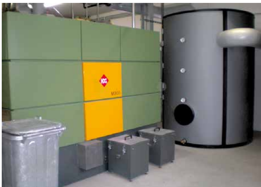
Die M300-400 wird in der Praxis häufig mit einem Pufferspeicher ausgestattet. Die drehzahlregelte Pufferladepumpe sorgt für eine besonders effektive Leistungsabgabe und liefert im kompletten Leistungsspektrum den passenden Volumenstrom.
